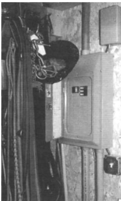
9.1. Располагайте электрический щиток в легко доступном месте
