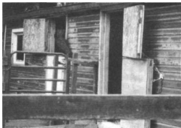
11.6. Наружная обшивка многих зданий мало пригодна для использования в тех местах, где есть лошади. Даже плоская поверхность этой покоробившейся обшивки будет вскоре повреждена лошадьми
